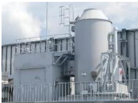
排ガス洗浄装置
