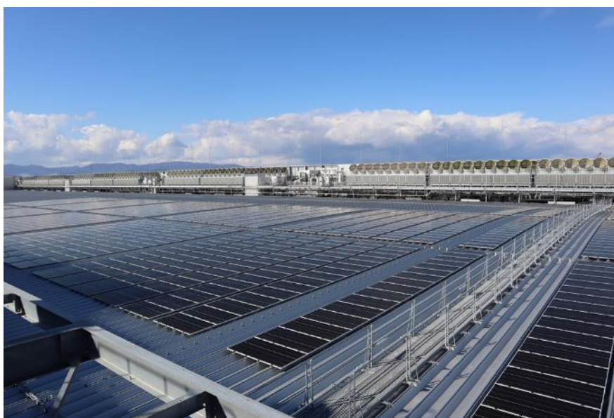
太陽光発電システム
