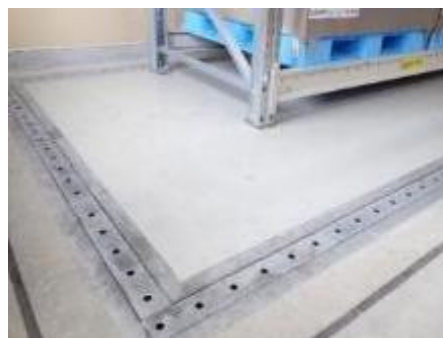
漏液防止ピット
