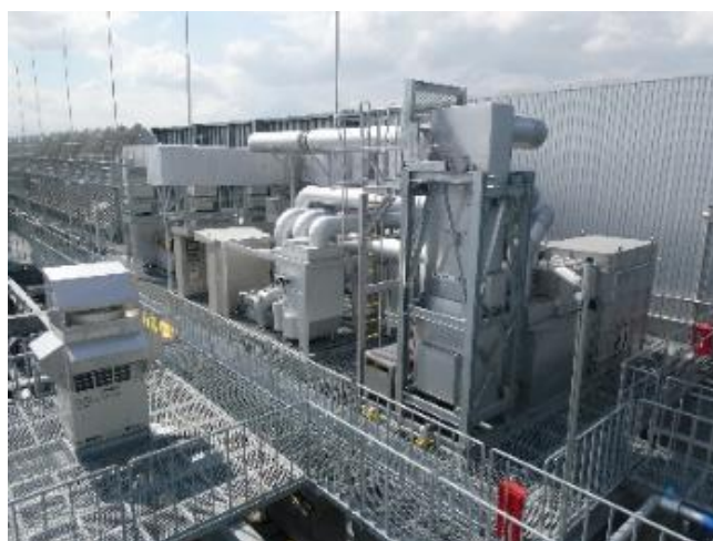
VOC 除害装置
